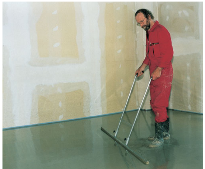
Mit dem Fließestrich PCI Periplan plus kann stehend in kurzer Zeit eine große Fläche eingebaut werden.
