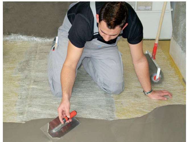
Die geeignete PCI Bodenausgleichsmasse wird auf der ausgelegten Glasfaser-Verstärkung PCI Armiermatte GFM ausgegossen und mit einer Spachtel verteilt (Mindestschichtdicke 5 mm).
